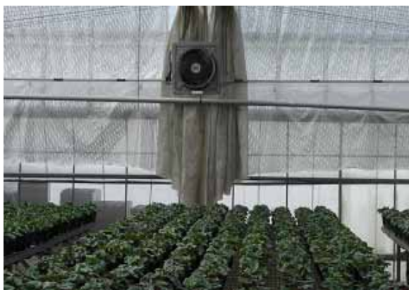
循環扇の設置状況
